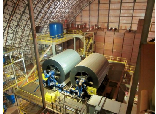
Équipement de traitement sous la structure du dôme abritant le complexe de traitement
